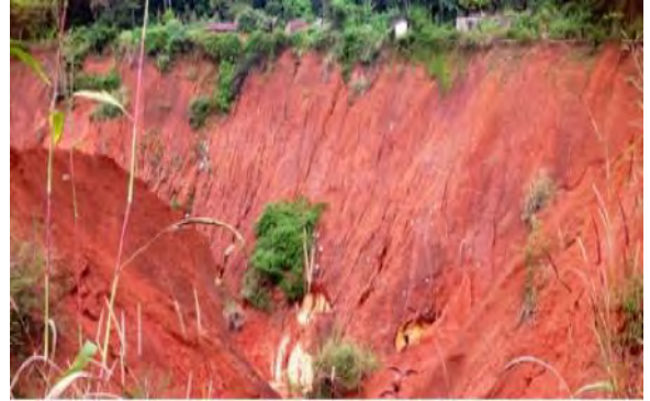
Figure 5: Slumping Site 4, Latitude 9° 46' 30'' Longitude 6° 8' 20''
